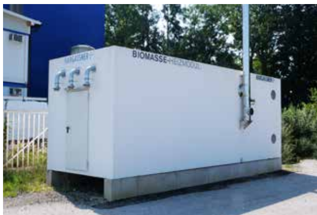
Enkelvoudig 120 kW pellets, Commercieel vastgoed
